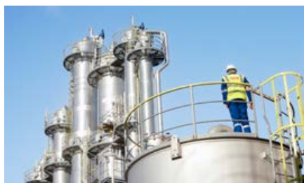
Separación de aire
